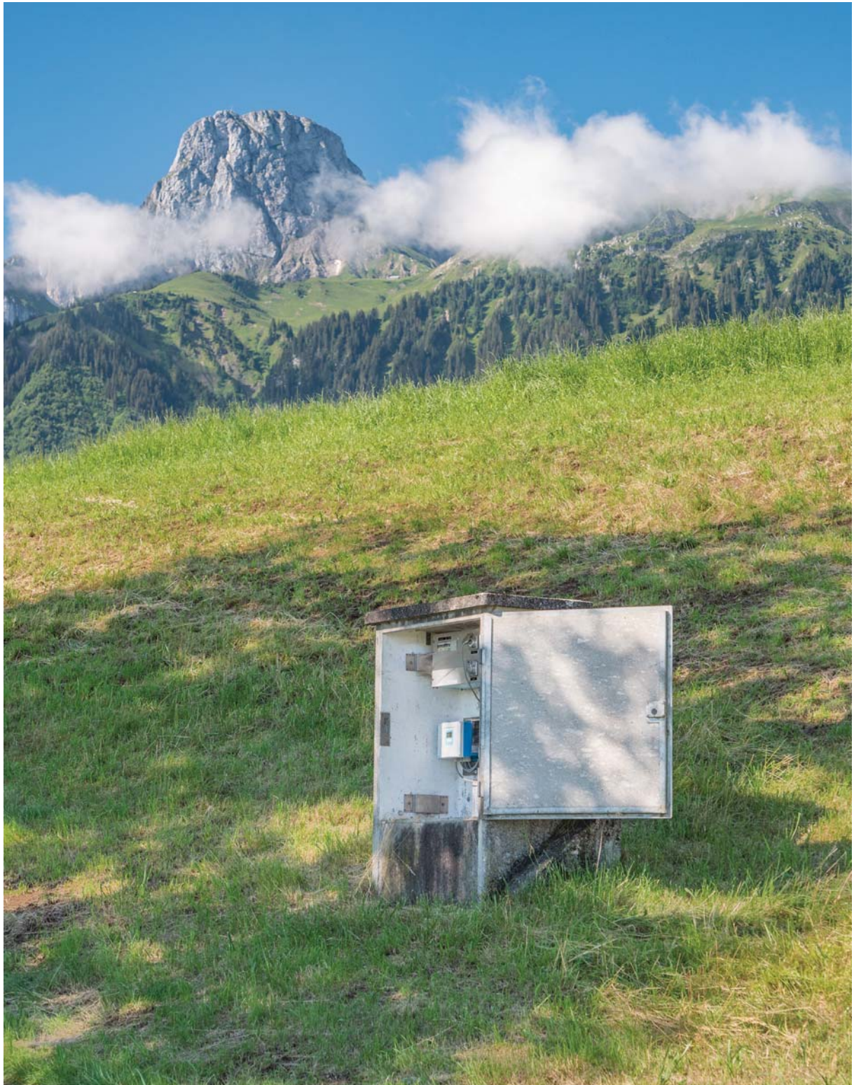
Die Abwasser-Messstelle Uebeschi vor prominenter Kulisse
